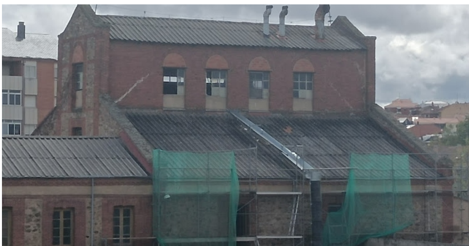
Los fondos permitirán seguir con la renovación del tejado de La Rosario, recién empezada
